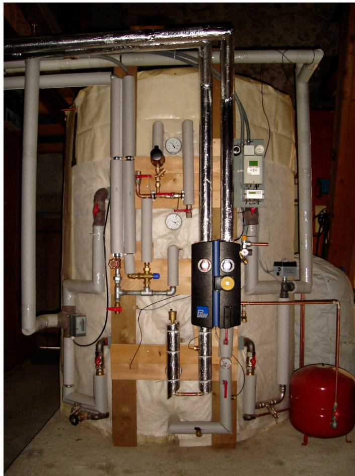
Figure 5 : Détail de l'accumulateur une fois complètement équipé.
