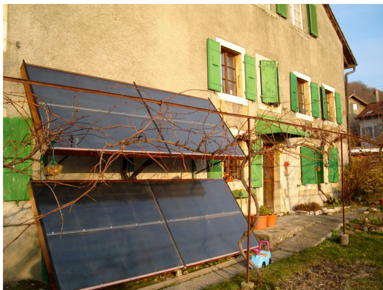
Figure 3 : panneaux solaires implantés en façade.
